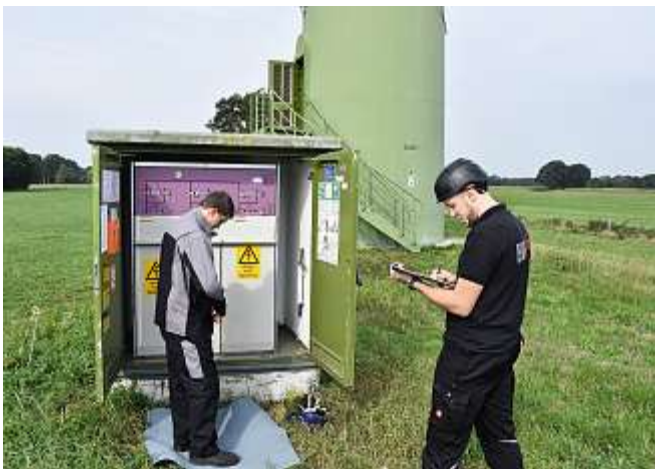
Bild 1: Vorbereitung zur Schalthandlung
