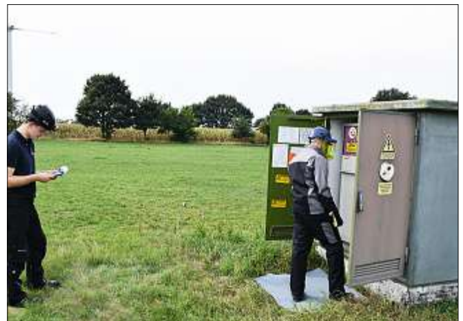
Bild 4: Abschluss der Schalthandlung
