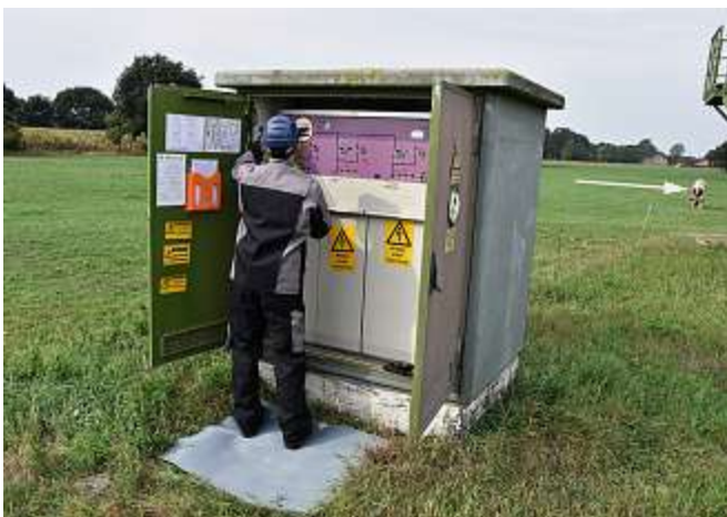
Bild 2: Jetzt wird geschaltet
