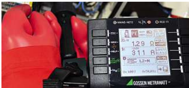
Bild 67: Ermittlung des möglichen Kurzschlussstromes ausgangsseitig am LSS mit 311 A
