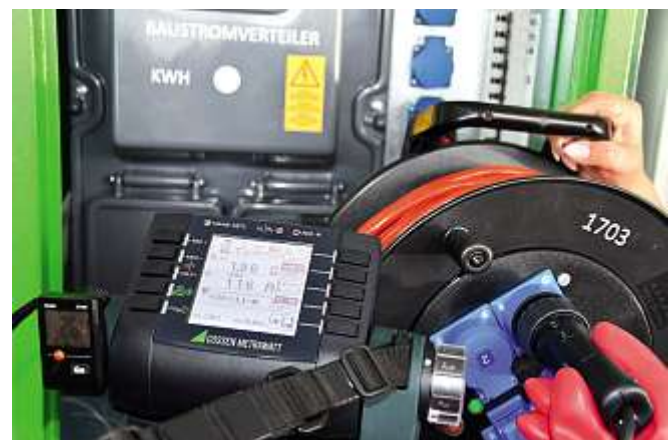
Bild 72: Messung zur Höhe des möglichen Kurzschlussstromes bei zusätzlicher Leitungslänge mit 116 A
