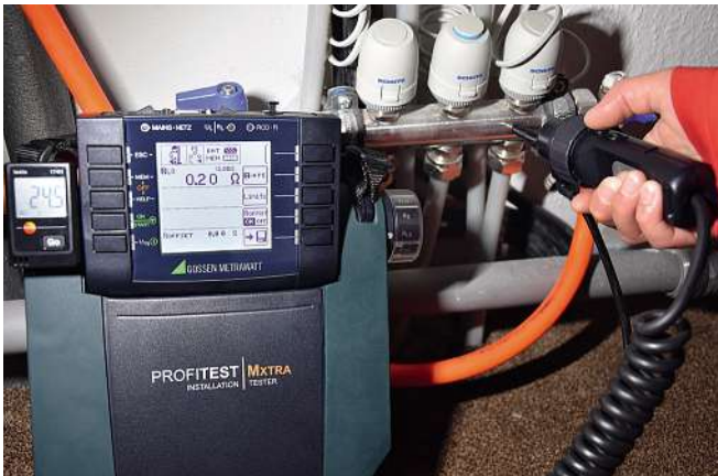
Bild 9: Schutzpotentialausgleichsleiter-Messung zwischen Haupterdungsschiene und einem Heizkreisverteiler mit einem zu erwartenden Messwert von 0,20Ω
