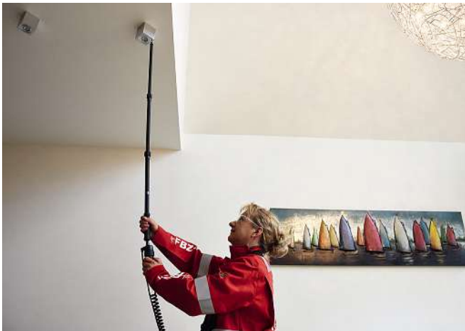
Bild 7: Schutzleitermessung mit Telearm zwischen Haupterdungsschiene und einem kompakten Körper einer Leuchte mit einem zu erwartenden Messwert von 0,41\Omega
