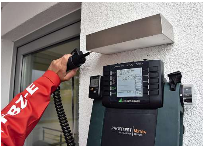
Bild 8: Schutzleitermessung zwischen Haupterdungsschiene und einer Außenleuchte mit einem zu erwartenden Messwert von 0,22\Omega
