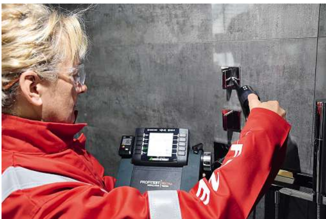
Bild 10: Schutzpotentialausgleichsleiter-Messung zwischen Haupterdungsschiene und einem Duschregler mit einem zu erwartenden Messwert von 0,30Ω
