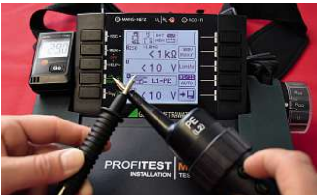
Bild 22: Isolationswiderstandsmessung zur Überprüfung der Funktionsfähigkeit mit einem zu erwartenden Messwert von <math>< 1\text{ k}\Omega</math>
