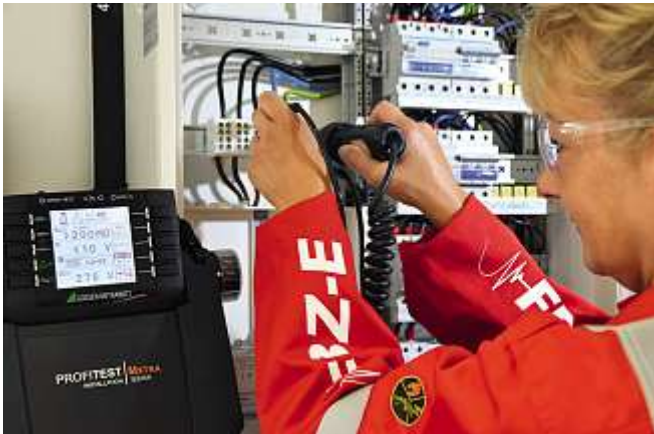
Bild 19: Isolationswiderstandsmessung an der Hauptleiterabzweigungsklemme mit einem zu erwartenden Messwert von >200\text{ M}\Omega
