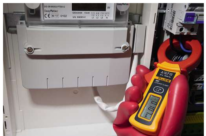
Bild 14: Messung an einem Beleuchtungsstromkreis mit Leuchten der Schutzklasse II zur indirekten Schutzleiterbestätigung mit einer Leitungslänge von 23m und einem zu erwartenden Wert von 0,107 mA
